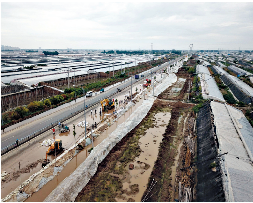
大型机械在寿光市纪台镇东方村附近308国道南侧挖排水渠。
