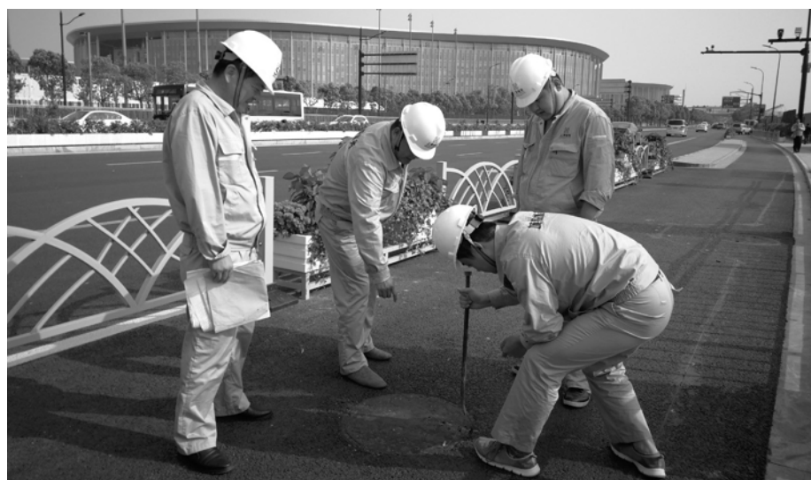
市经信委城市能源保障青年突击队为进博会能源保障保驾护航。
