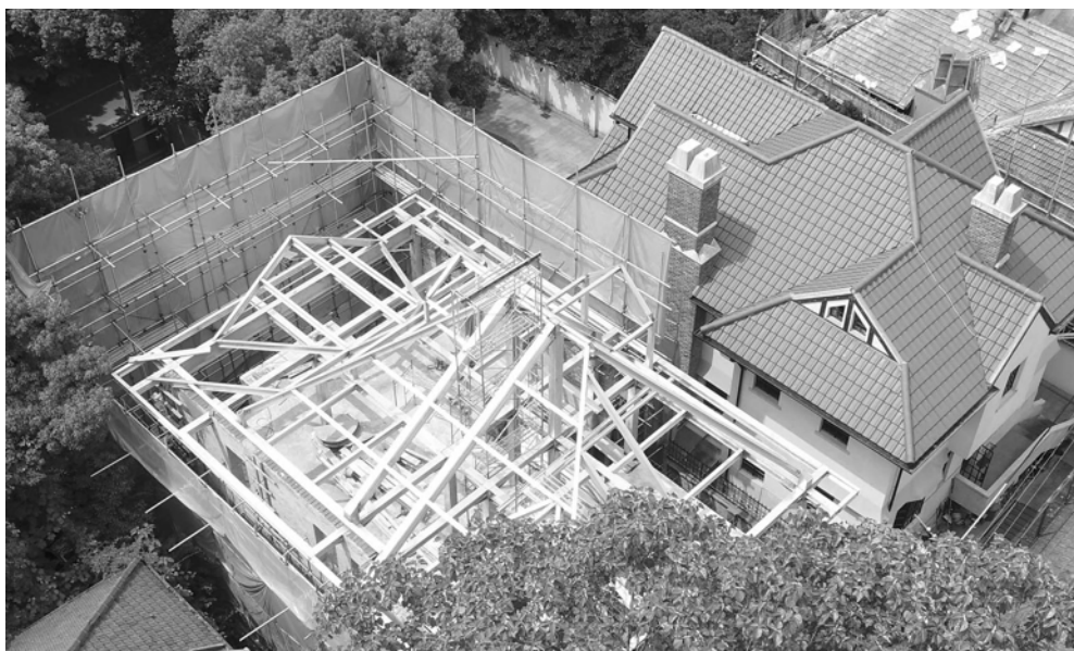
被违规拆除的巨鹿路洋房。
