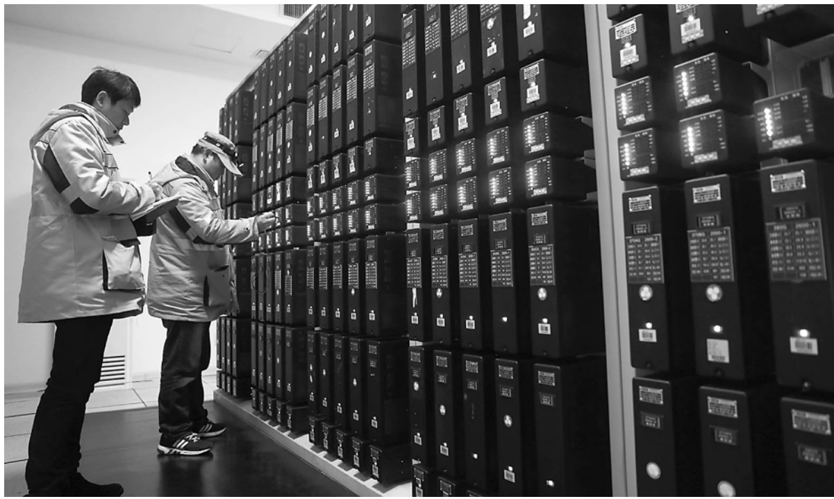
2月5日凌晨，在上海松江南站，高铁维修工在信号机房内作业。
