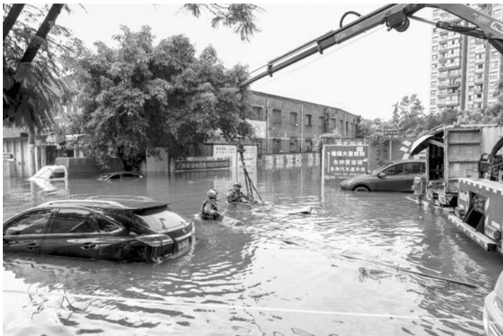
6月21日，重庆大渡口区的消防救援人员在积水中使用抽水泵抽取城市道路积水。
