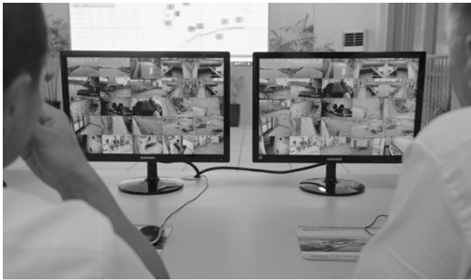
金汇港南闸的工作人员在监控屏幕上各区域动态。
