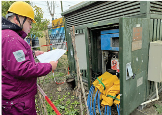
松江公司电缆班青年王睿在箱变改造工作中核对电缆安全措施。
