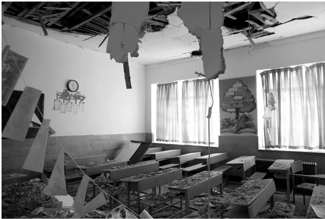
3月3日，在伊朗德黑兰市中心的沙希德·马哈拉提学校，教室房顶塌落，地面一片瓦砾。 新华社 图
