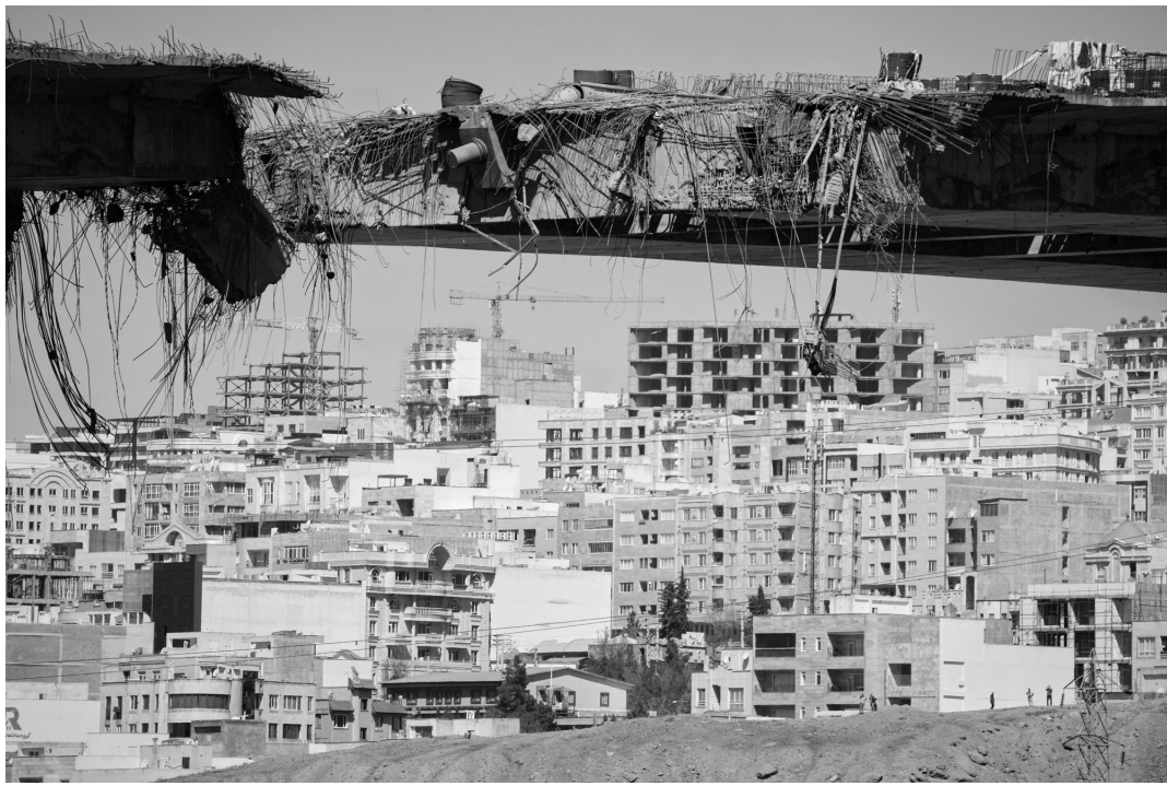
遭袭受损的伊朗卡拉季市贝伊克公路桥。
