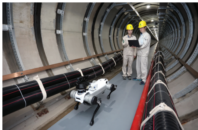
“缆”智慧青年突击队成员现场操作智能巡检设备。
